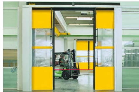
Einweg-Lichtschranke in einem Schiebtor
