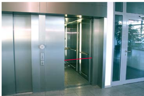
Einweg-Lichtschranke in einer Aufzugstür
