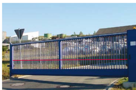
Einweg-Lichtschranke in einem Schiebtor im Außenbereich
